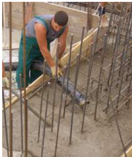
La P 718 refoule entre autres du béton fin jusqu'à une granulométrie de 32 mm.
